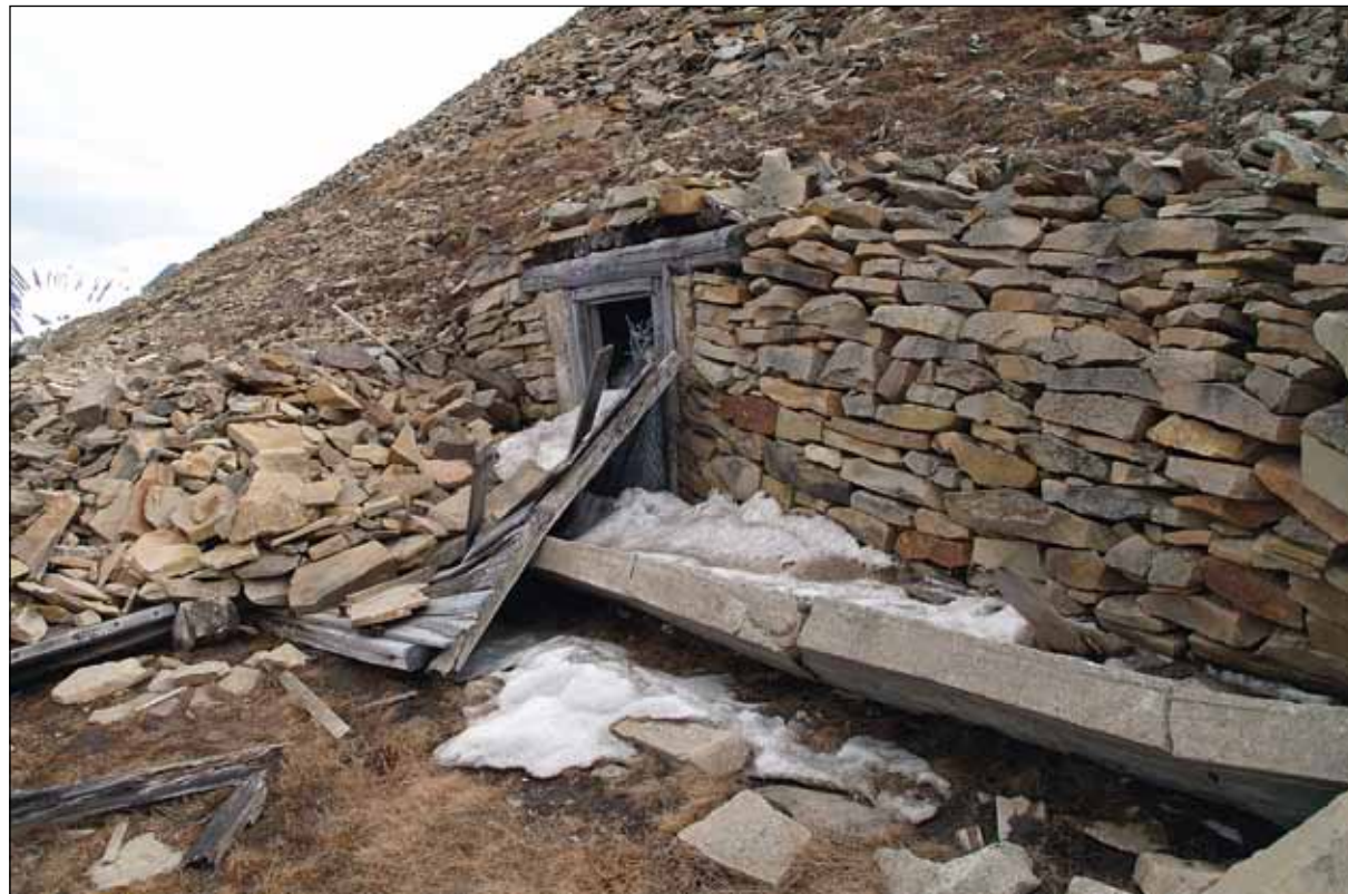
Gamle gruveåpninger og –sjakter kan være farlige å ta seg inn i. Sikring av gruvene er eiers ansvar. En av åpningene inn til gruve 2a under toppen av Sukkertoppen, Longyearbyen.
