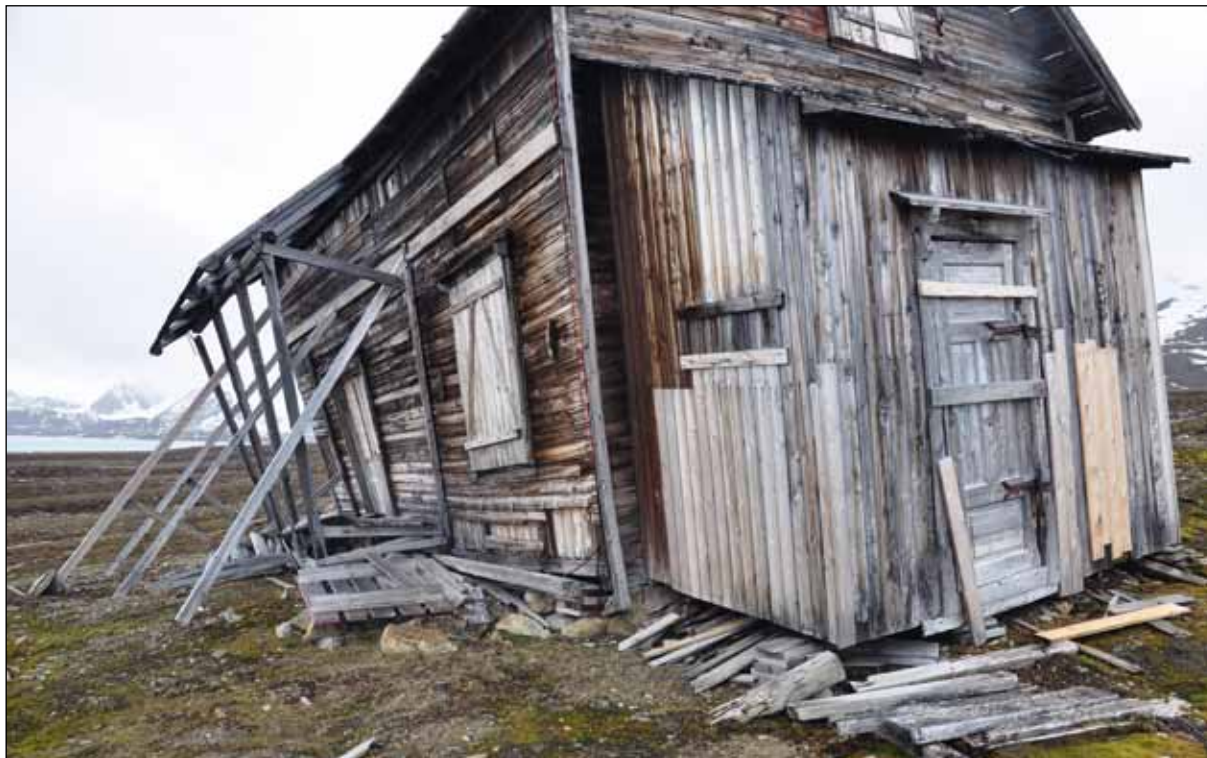
Gjæverhuset i Recherchefjorden er ett av de høyt prioriterte kulturminnene på Svalbard. Hytta er bygget på svært fuktig grunn, og den vil derfor ha begrenset varighet. Sysselmannens håndverkere har stropet bygningen sammen og støttet den opp for å motvirke forfallet.
