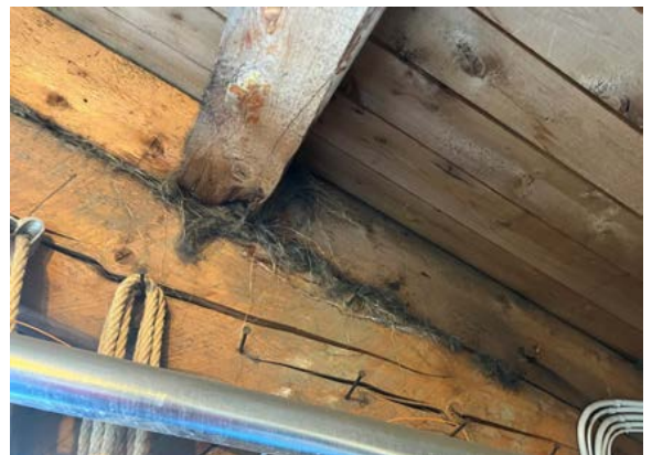
Gammel dyttetry mellom gavlvegg/tak mot nord.
