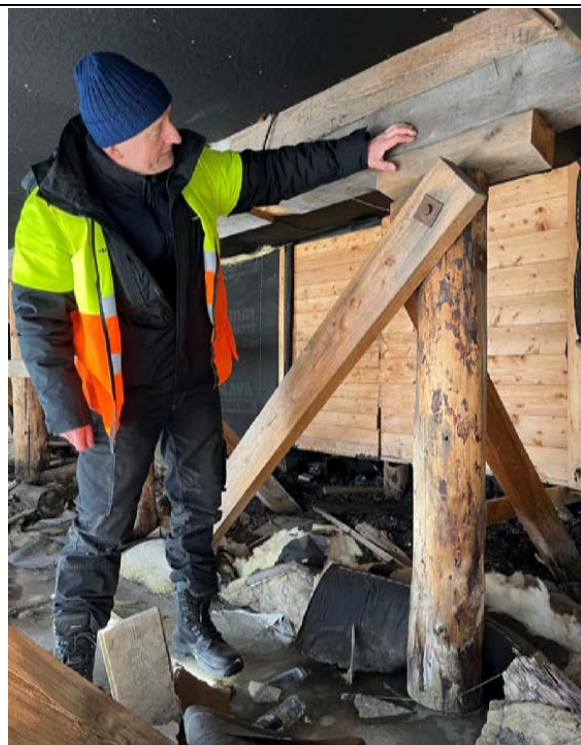
Pelefundament med noe skjevsatt kloss over. Under deler av bygningen er det smeltevann/is.
