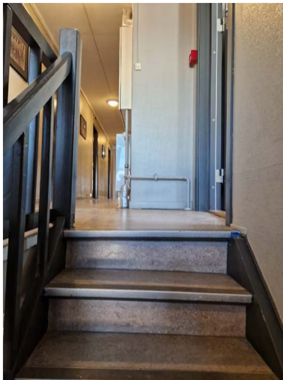
Ser inn i 2. etasje. Gulvet ved veggfelt rett frem i bildet kan se ut til å ligge noe høyere enn gulvarealet rundt grunnet setninger.
