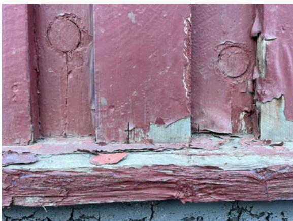
I nedre del av veggen er det noen store pluggete hull, muligens etter innblåst isolasjon (ingen plugg hull høyere på veggen).
