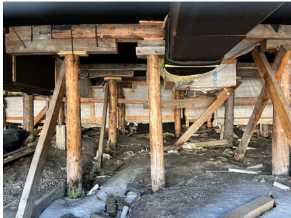
Pelefundamenter under sørvestre del av bygningen, også her med oppklossing og kryssavstivinger, noe usikker stabilitet. Vannspor og muligens (skjult) råte i nedre del av pelene.
