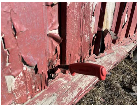
Små lokale råteskader i nedre del av kledning. Omfattende malingsavskalling.
