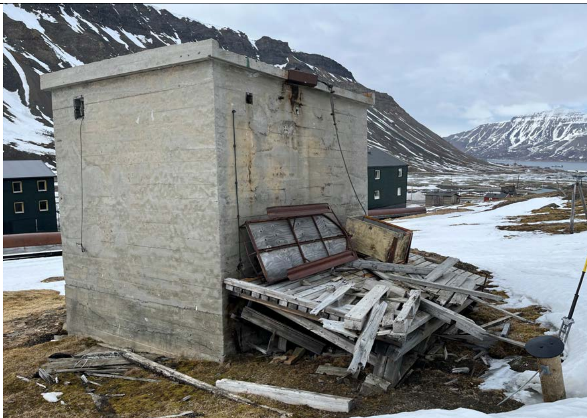
Fasade sør og øst. Trammen mot øst er nedfallen og har diverse lagret utstyr. Her har det stått et tilbygg.
