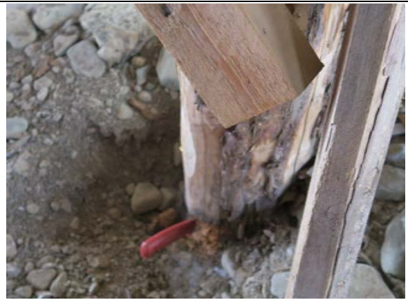
Peler med betydelig råteskader. Kniven går dypt.
