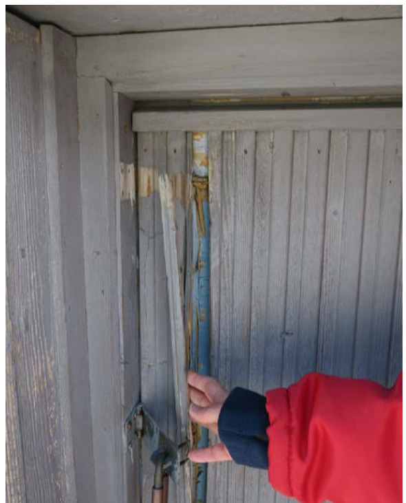
Detalj av ramtredør, kledd med smalt skyggepanel på utside og blåmalt fyllingsdør bak. Lokal skade.
