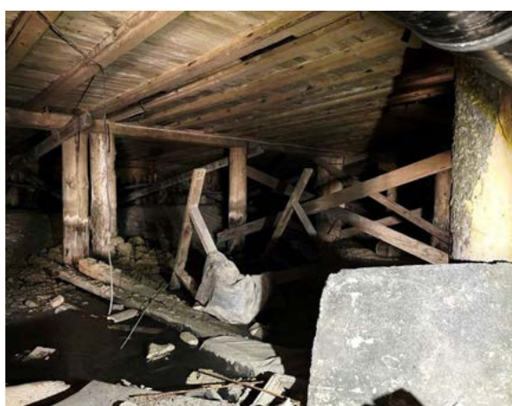
Det er mye overflatevann (dammer) som har frosset til et tykt islag under bygningen.
