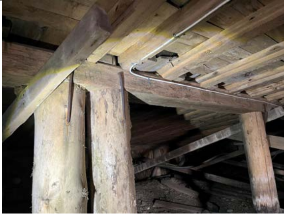
Gamle bindhaker av jern mellom pelegfundamenter og bjelker under dekket.
