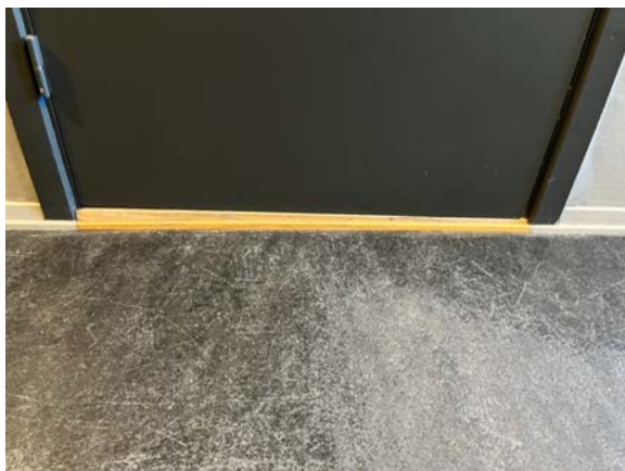
Skrå avretting av list under dør, utført på 1990-tallet eller senere. Ikke merkbar utvikling av setningen.
