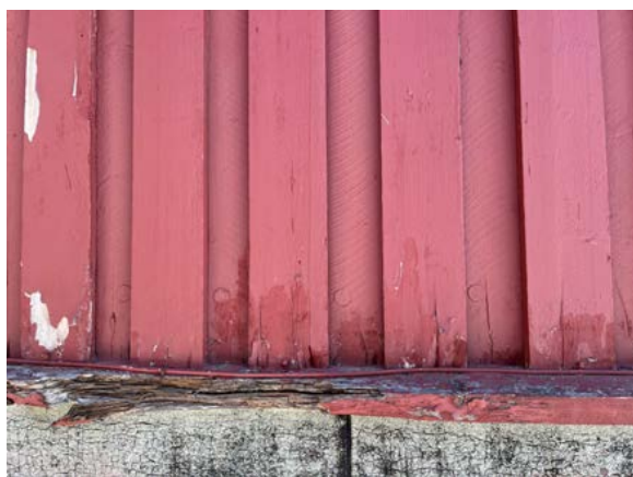
Det er lokale råteskader i vannbrett mot sør og vest. Eventuell følgeskade i svill er ikke undersøkt.
