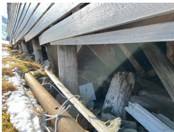
Fundamenter under østveggen. I søndre del (bak i bildet) er flere peler skjevsatt grunnet terrengsig.
