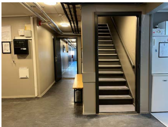
Opprinnelig trapp mellom 1. og 2. etasje. Flere opprinnelige detaljer er bevart. Avrettet skjevhet under åpning, dørhengsler står i karm.
