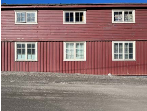
Fasade vest. Kledningen er fornyet i feltet der dør og lasterampe er fjernet. (Skitten snø foran vegg.) Bygningen har tømmermannspanel i 1. etasje og liggende supanel i 2. etasje, som opprinnelig.
