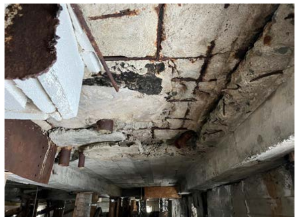
Under deler av betongdekket er armeringsjern avdekket og noe rustne. Jernarmeringen har svært tynn overdekning i støpen. Her ses et parti under bygningens nordvestre del.
