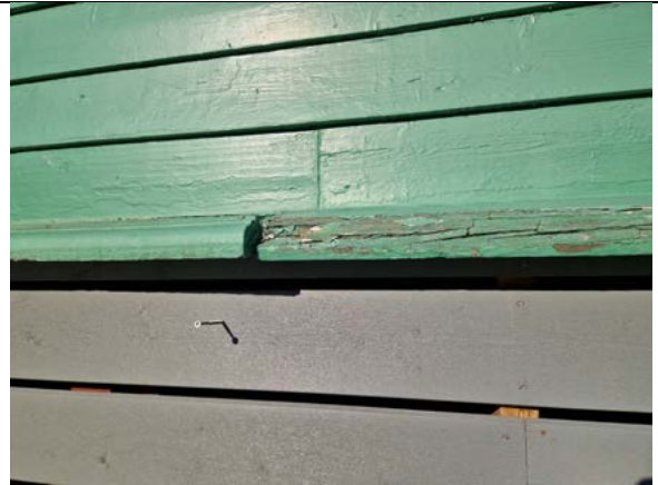
Detalj av råteskade i vannbrett, ref. bildet til venstre. Vannbrettet er bevart med opprinnelig profil (øvre hulkil, liten vertikal kant, og avrundet nedre del).
