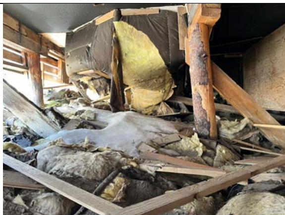
Under sørøstre del av bygningen er det noe uryddige løsninger (isolasjon). Generelt mye kapp og skrot under bygningen. Pele med oppklossing er noe vridd.
