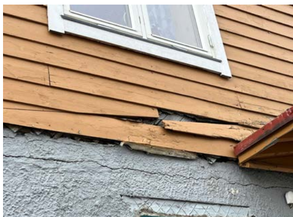
En skade i opprinnelig supanel over lasterampa avslører det opprinnelige skråstilte panelet bak, som er spikret rett på bindingsverket. Den støpte kjellerveggen har utvendig spritpuss.
