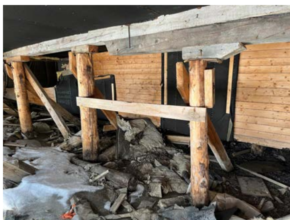
Flere peler har noe ustabil oppklossing i overkant. Kjellerrom (opprinnelig støpt) med trekledning.
