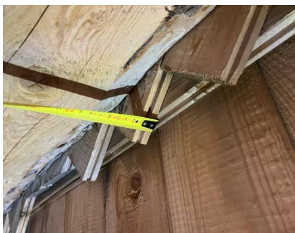
Opprinnelig skråtelt kledning spikret direkte utenpå bindingsverket i yttervegg henger noe ned, pløyd ca. 22 mm.
