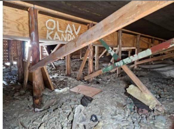
Eldre peler med kryssavstivning under hovedbygget. Det er betydelige råteskader i peler ved terreng.
