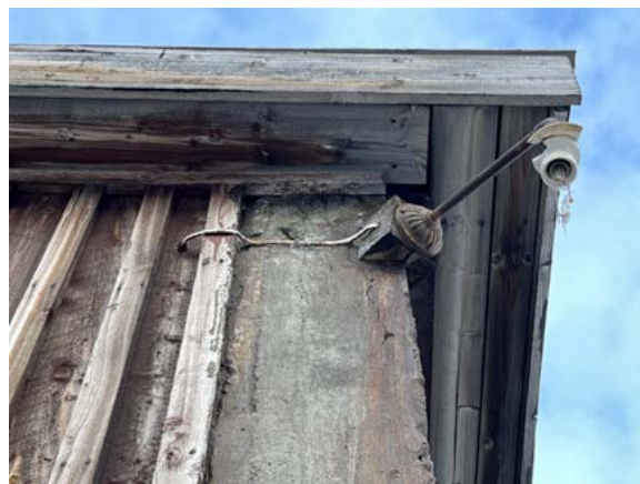
Gesimsdetalj og eldre lampett hjørne sørvest.
