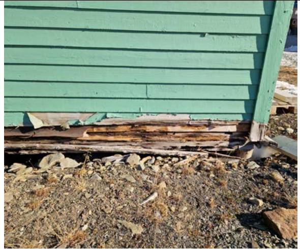
Utbygg mot sør. Omfattende råteskader i kledning og bunnsvill på hjørne sørøst.
