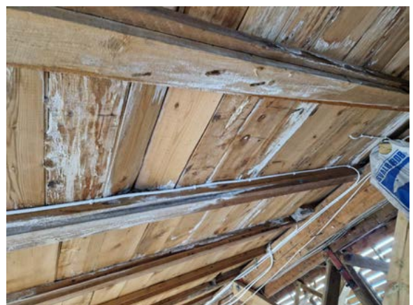
Stubbeloftsbord med lokalt saltutslag (?). Der bord løfter seg litt, kommer det ut kullsubb fra det opprinnelige stubbeloftsfyllet.
