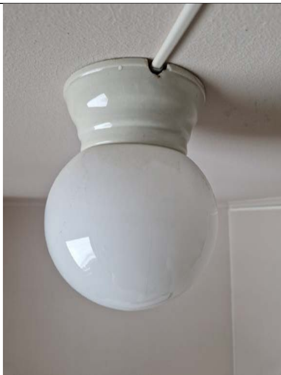
Eldre profilerte porselenssokler med opale glasskupler som belysning i de fleste brakkerom.
