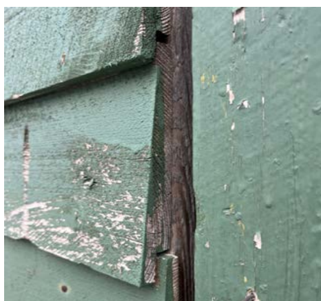
Opprinnelig skråskjært supanel.
