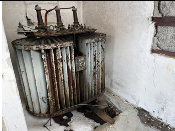
Antatt opprinnelig transformator fra Merlin Gerin.
