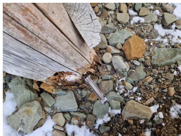
Opprinnelige peler som fundament for betongvegger til gammelt fyrrom. Det er betydelige råteskader, kniven går helt inn.
