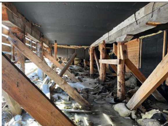
Typisk fundament under østre del. Mange peler er byttet ut og har ny kryssavstiving. En del overflatevann har samlet seg og frosset til is omkring enkelte trepeler.
