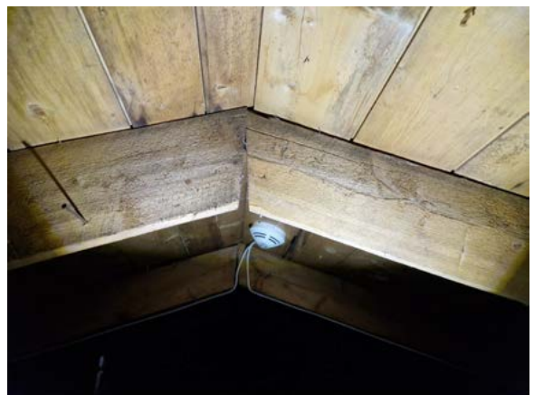
Sperrene står mot hverandre uten innfesting i hverandre ved mønet. Glipper kan tyde på noe bevegelse/utglidning.
