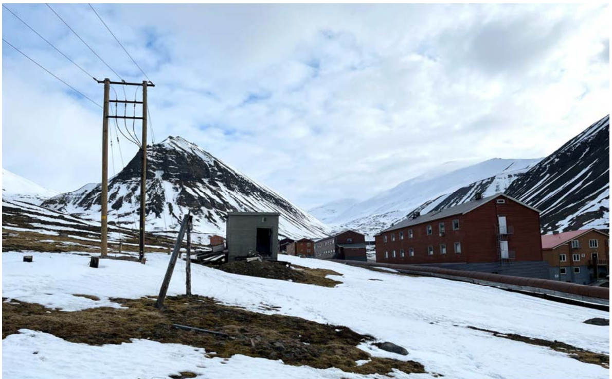
Strømmast ved trafoen. Tre ledninger går ned i bakken ved trafoen, hvor strømmen ble omdannet til lav spenning og ført ut til bebyggelsen i Nybyen. Tilsvarende master (eldre typer) fortsetter ned til Haugen.
