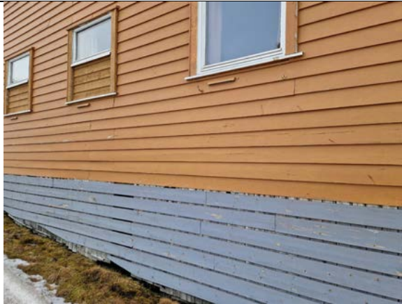
Langvegg MOT øst. Blending av vinduer ved etablering av bad. Opprinnelig format er markert med listverk. Luftesystem/ventiler under vinduer. Det er ikke vannbrett som avslutning under supanel mot nyere skjørt. Gammelt stående panel er bevart under nye liggende bord i plankeskjørtet.
