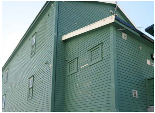
Opprinnelig utbygg mot nord, fasade øst. Spor i fasaden etter endring av vinduer både på utbygg og hovedbygg.
