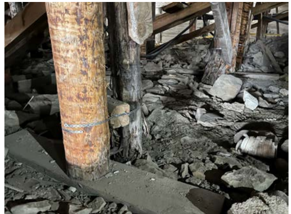
Nye peler står på pute/plankebit over terreng. Alvorlig råte/svikt i opprinnelig pele like bak, som står forankret ned i bakken.
