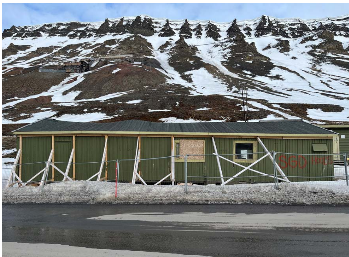
Fasaden mot veien med karakteristisk lektepanel og papptekket tak. Midlertidig sikringstiltak er utført.
