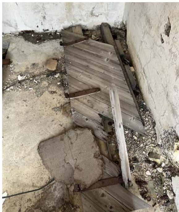
Et skadet dørblad (fra nordvegg) er bevart inne.
