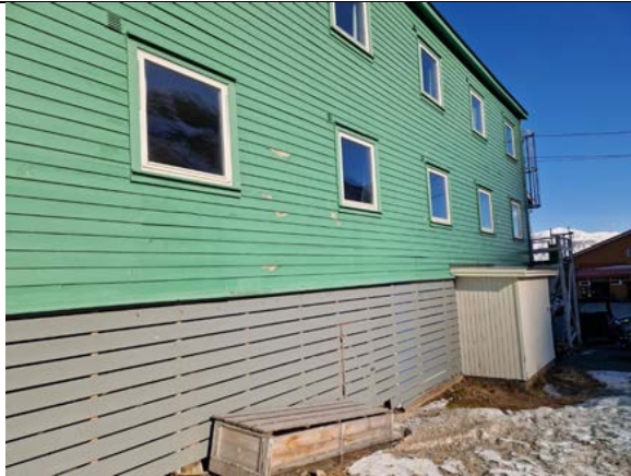
Langvegg mot øst, med lokal råteskade i vannbrett mellom panelt vegg og skjørt (under nærmeste vindu).
