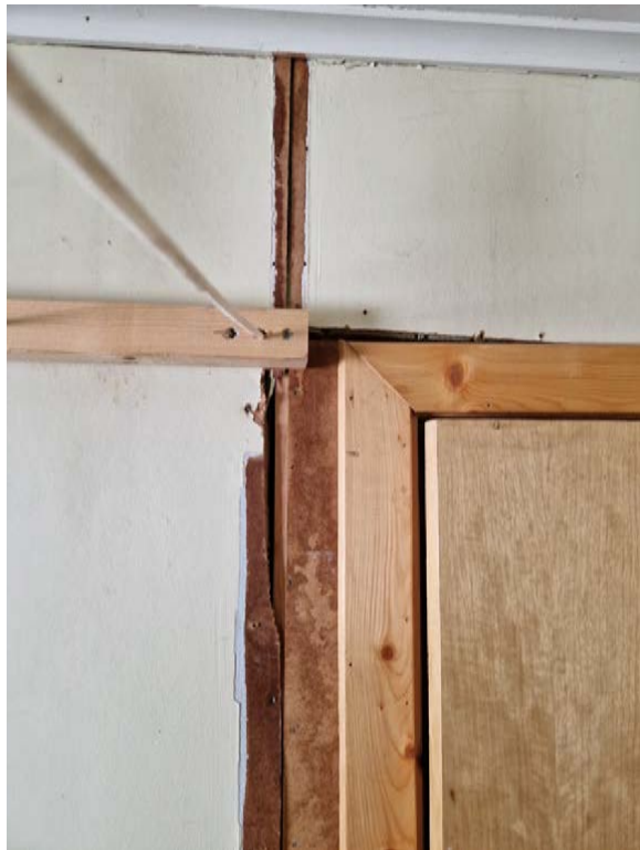
Utbygg mot sør, detalj dør inn til korridor i brakke, der list er fjernet fra huntinittkledningen.
