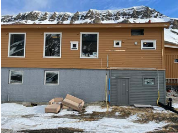
Utsnitt fasade vest. Noe endrete vinduer i søndre del. Sprekk i øvre del av støpt kjeller langs hele bygningen.
