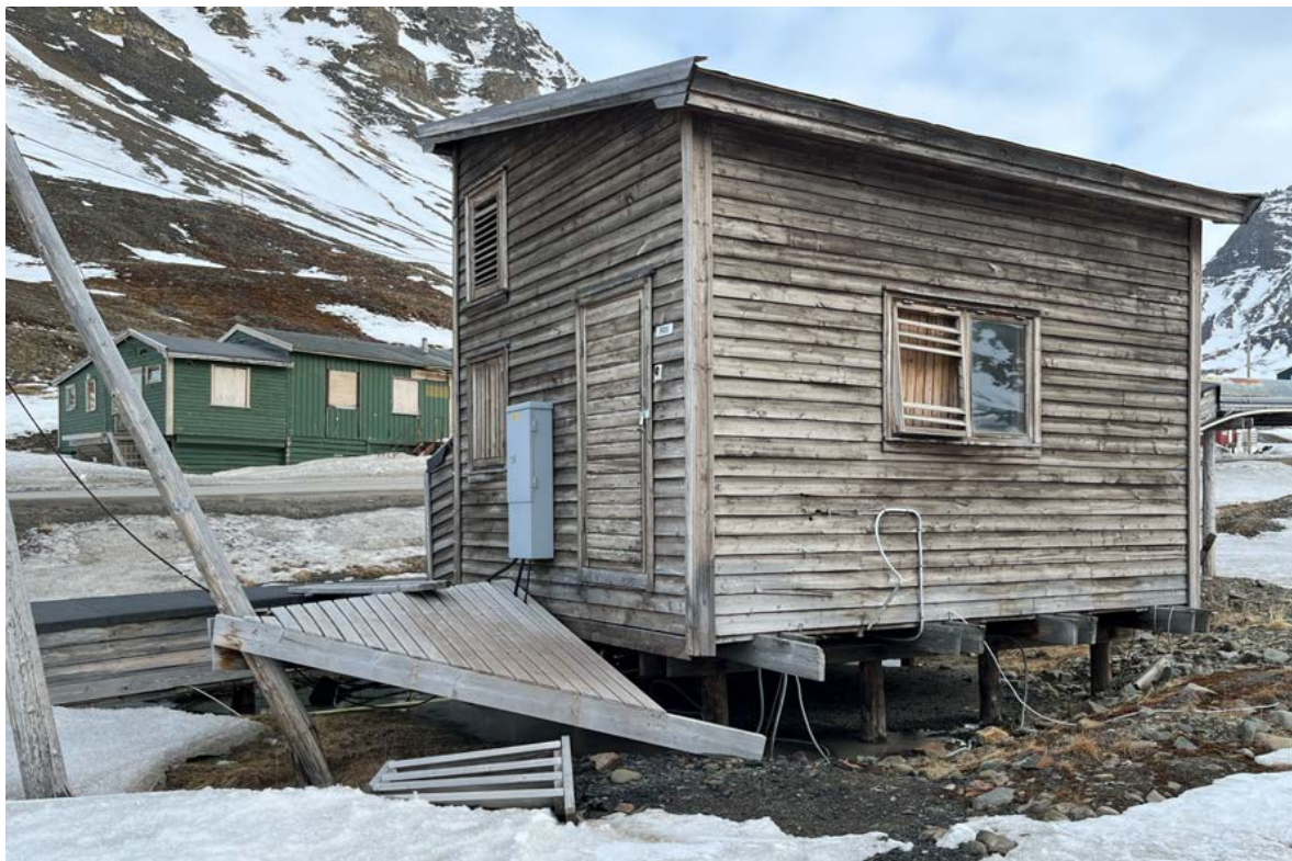
Pumpehusets fasade nord, med inngangsdør og nedfallen tretram. Fasade vest med vindu og ventil.
