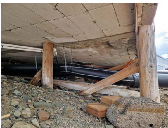
Under fyrrommet. Det er store råteskader i peler og kryssavstivning ved terreng. Mindre partier av Siporex-platene er forvitret/nedfalne.
