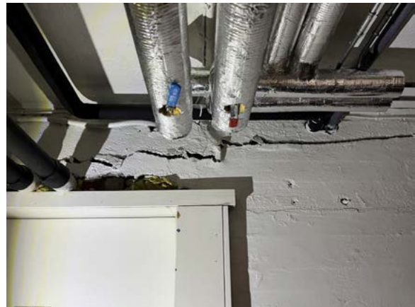
Detalj av sprekk i betongvegg i kjeller. Tilsvarende sprekker finnes i både yttervegger og innervegger. Ifølge eier er situasjonen stabil etter istandsetting av pelefundamentene.
