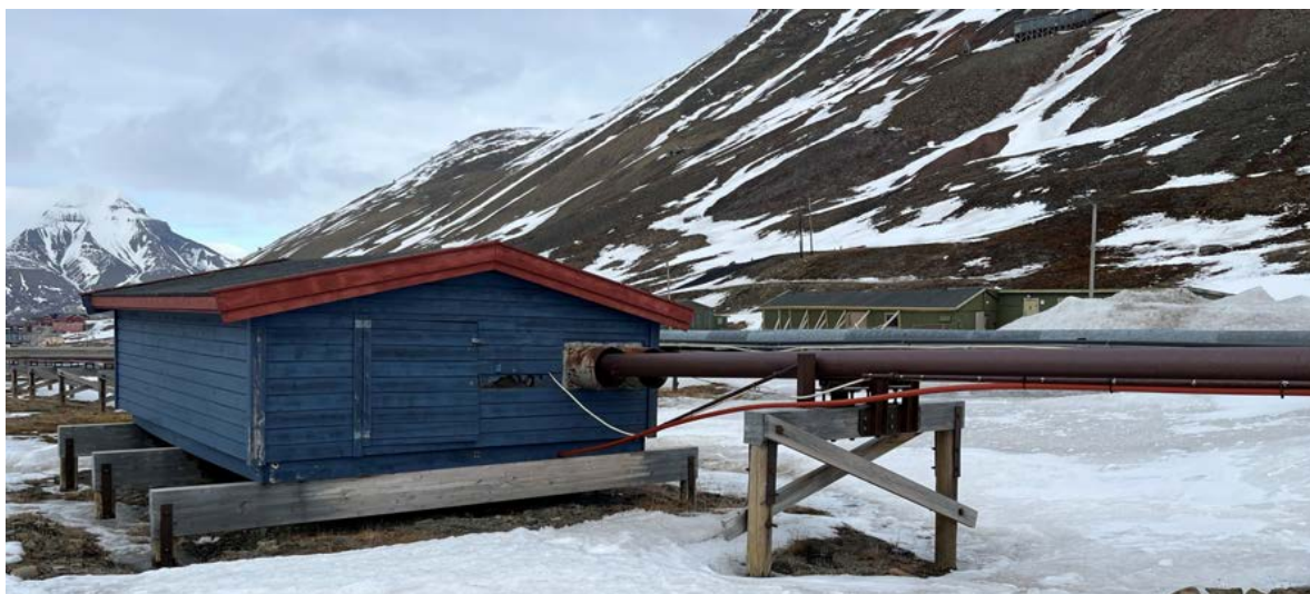
Gavlveggen mot sør har luke inn til teknisk rom. Rørgata fortsetter sørover til nytt fyrhus i Nybyen.
