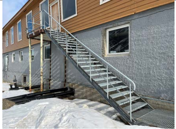
Rømningstrapp mot vest. Rustent stål i dekke og søyler, nyere trapp med trinn av strekkmetall.
