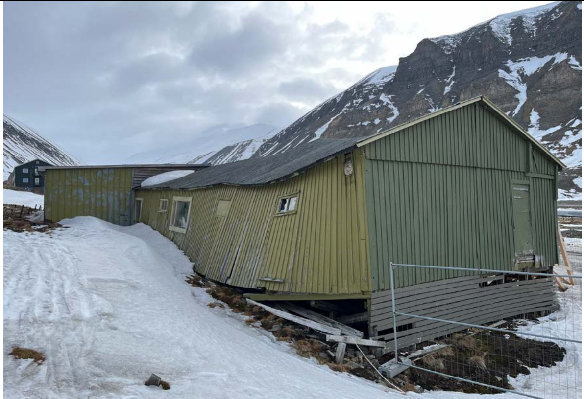
Anlegget fra nordøst. Maleverkstedet er tilbygget mot sør. Østfasaden er bevart med flere opprinnelige små vindusåpninger, plassert innenfor hver sin lembredde. Terrengsig og manglende vedlikehold har medført at fundamentet har glidd ut og det er store utglidninger i østveggen og takkonstruksjonen. De fleste lemmene og store deler av konstruksjonsmaterialet er mulige å gjenbruke ved restaurering.
