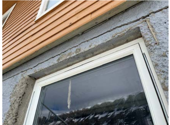
Langsgående sprekk i øvre del av støpt kjellervegg mot vest.
