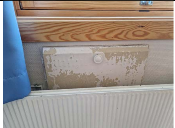
Alle vinduer har luftesystem under vinduer – synlig på utsiden som en smal avlang lufteventil rett under vinduet. Her brakkerom 1. etasje.
