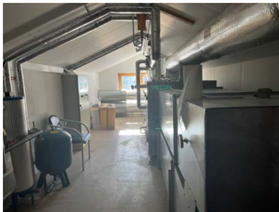
Innredet teknisk rom i søndre del av loftet.
