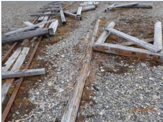
Råte konstruksjonsdeler i Skansbukta tåler ikke mye tråkk. Foto: Hans Olav Stegarud
